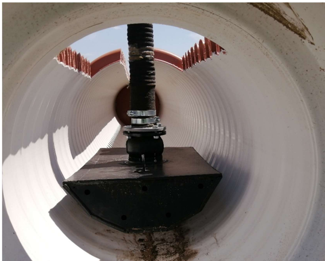
Рисунок 3.13 – Водозаборное устройство внутри лотка
